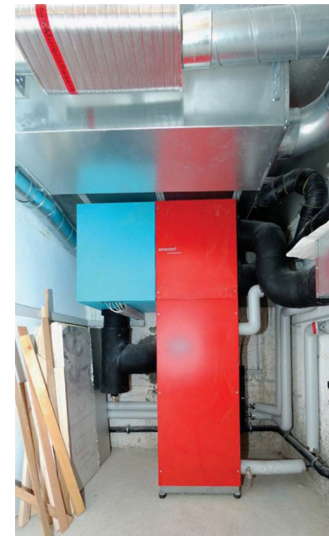
Kompaktgerät: versorgt das Haus mit Frischluft und Heizwärme.
